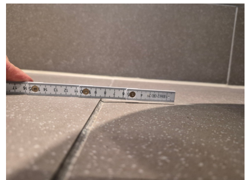
Kanter mellom fliser. Noe ufagmessig utført.
