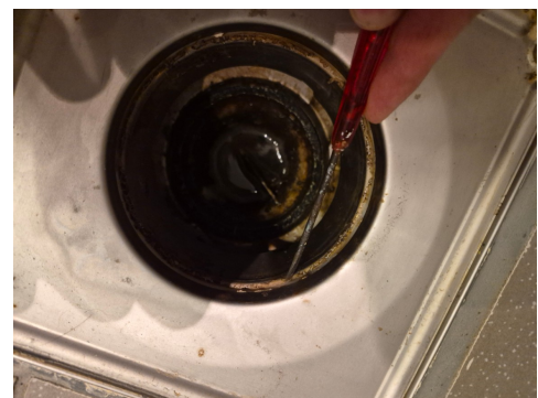
Sluk. Slukmansjett er påvist.
